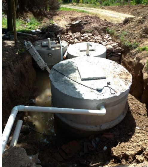
Figura 4: Instalação do tratamento de efluentes. Fonte: O autor, 2022.
