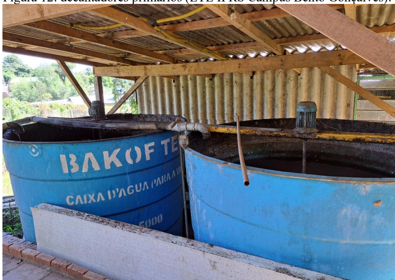
Figura 12: decantadores primários (ETE IFRS Campus Bento Gonçalves).
