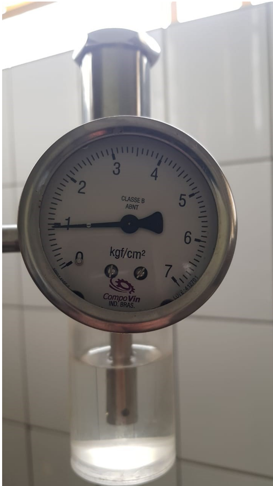
Figura 24: Manômetro – tanque de fermentação
