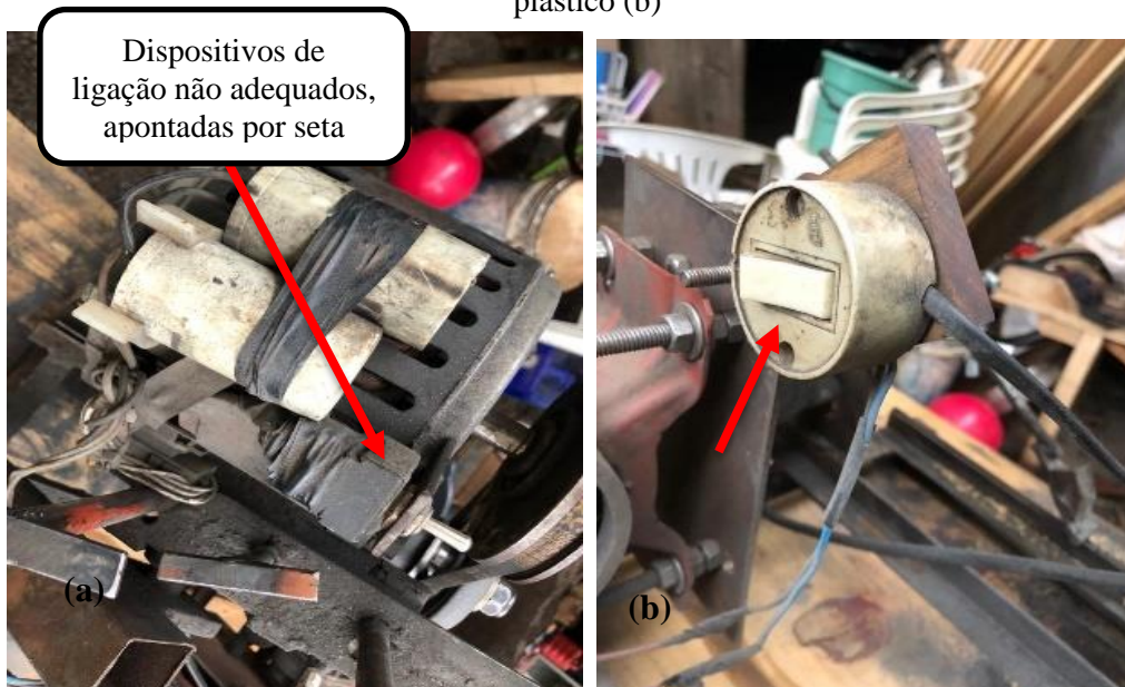
Figura 14 – Não adequação no dispositivo de ligação da botoeira de aço (a) e do interruptor de plástico (b)
