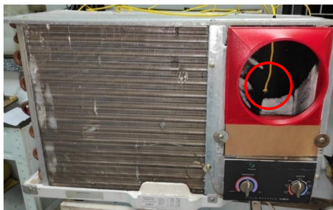
Figura 29 – Termopar instalado na saída do trocador de calor interno
