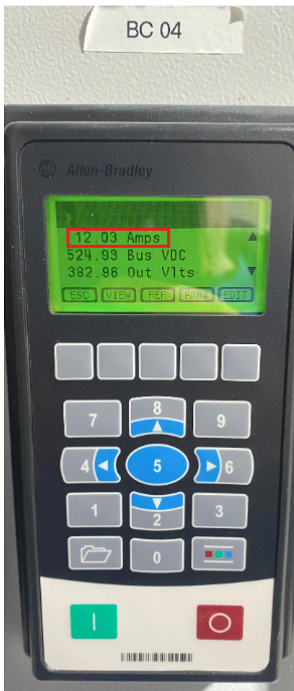
Figura 35 - Corrente elétrica das bombas de água gelada.
