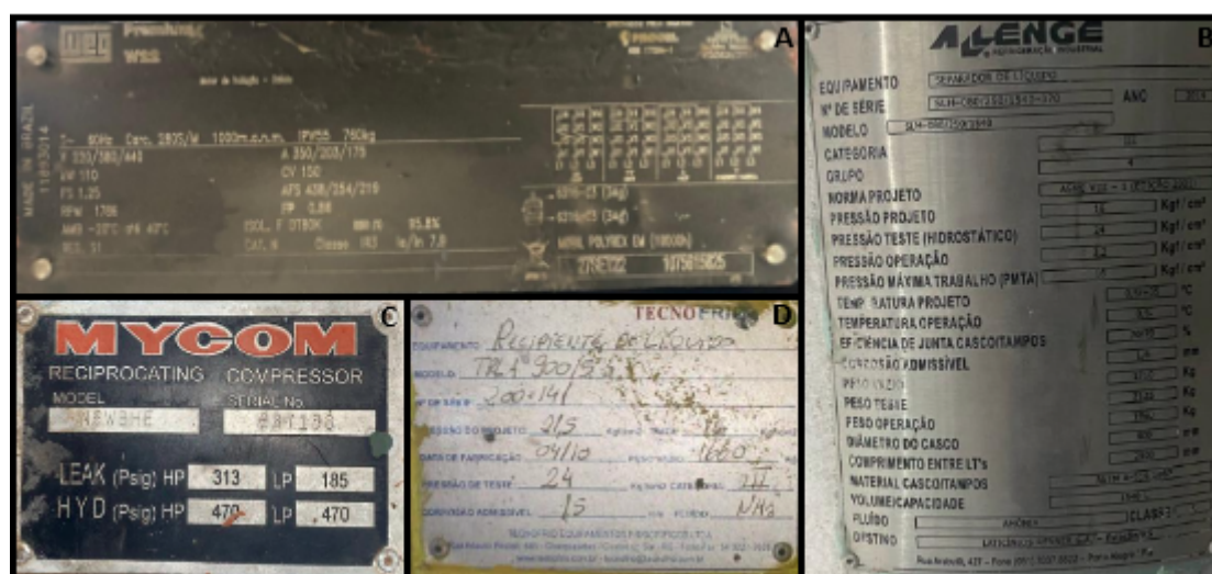
Figura 29 - Placa de identificação de equipamentos. (A) motor elétrico, (B) separador de líquido, (C) compressor de amônia e (D) reservatório de líquido.
