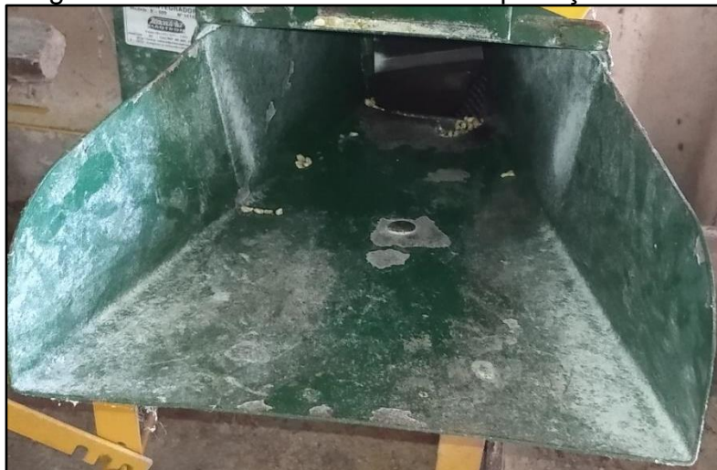
Figura 18 – Calha de entrada sem a proteção móvel.
