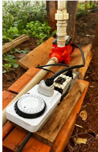
Figura 4: Conjunto moto bomba com o temporizador.
