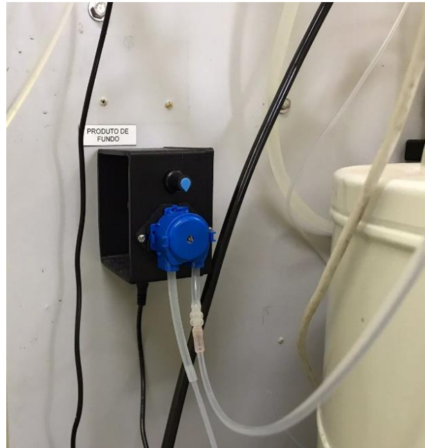
Figura 17 – Bomba peristáltica do produto de fundo.
