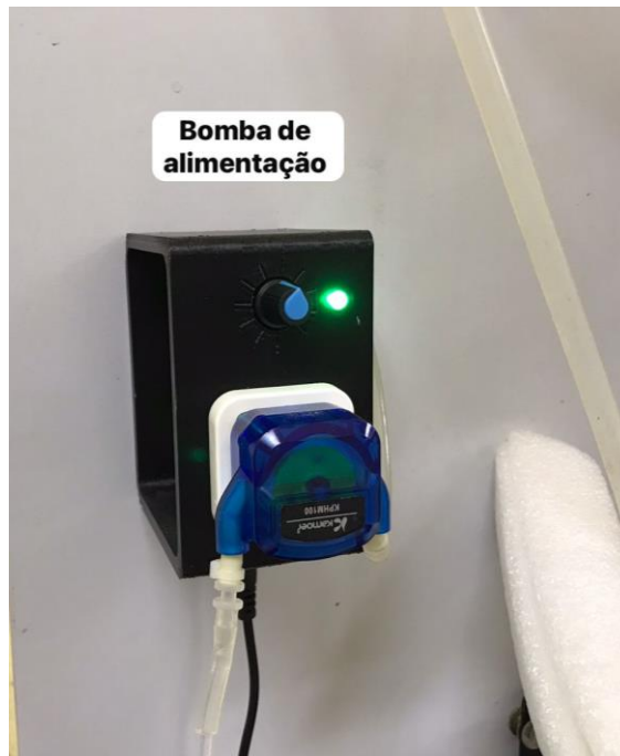
Figura 15 – Bomba peristáltica de alimentação
