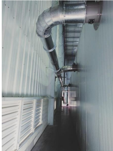
Figura 9 - Saída dos dutos. Fonte: Autor.
