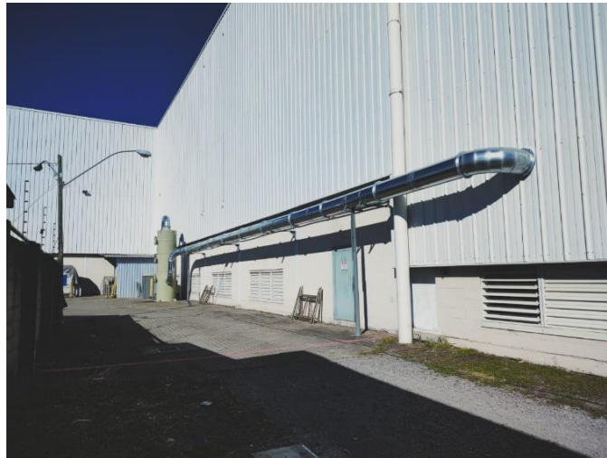
Figura 10 - Dutos externos. Fonte: Autor.
