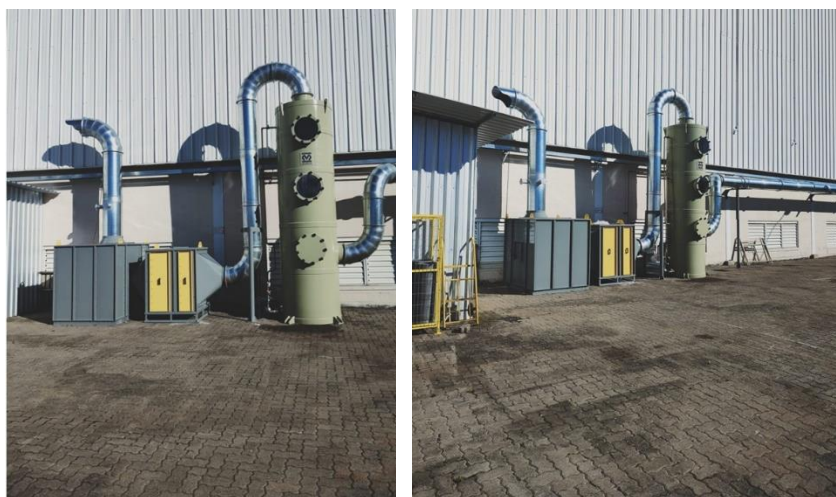
Figura 11 - Lavador, filtros e duto de liberação do ar. Fonte: Autor.
