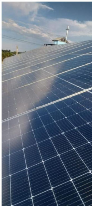
Figura 9. Sistema de produção de energia fotovoltaica, que corresponde a 100% da necessidade energética fabril, composta por 130 placas de 540w, com produção de aprox. 8.000kwh mensal e 85.000kwh anual.
