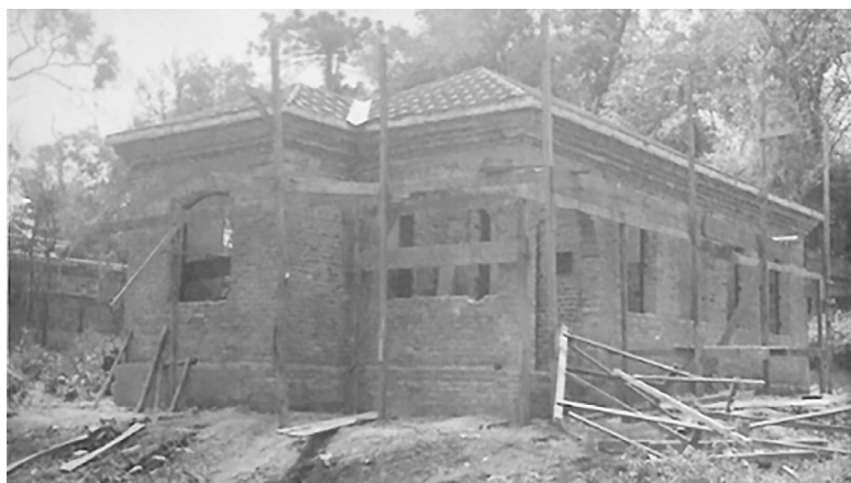
Figura 12. Residência em construção durante a instalação da Estação Experimental de Trigo de Passo Fundo entre 1939 e 1940. Fonte: Arquivo pessoal de Dr. Luiz Ricardo Pereira.
